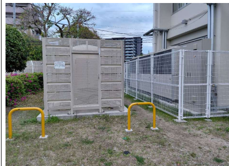
室外機・バルクタンク
