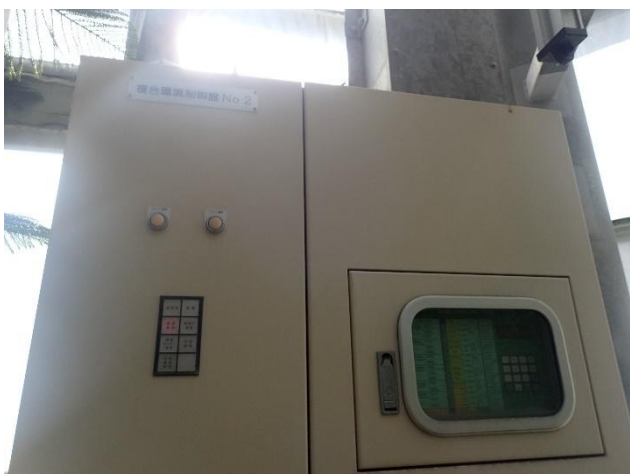
②温室2の制御盤 電源が入らない
