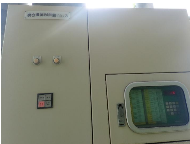
③温室3の制御盤 自動開閉が効かずに一部の窓が開かない (または閉まらない)
