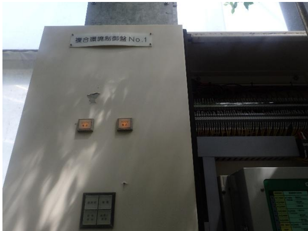
①温室1の制御盤 自動制御が不能
