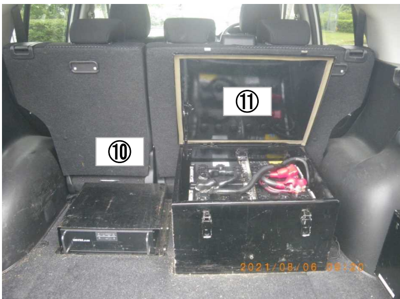
⑩車載用電カアンプ、鋼製保護カバー
